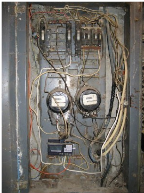
Рис 2. Исходное состояние зоны учета этажного щитка
