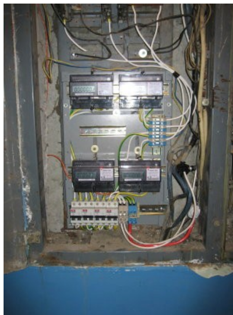
Рис 5. Через 30 минут все смонтировано, к модулю подключены питающие цепи и отходящие цепи на квартиры. Все потребление находится под учетом, счетчики опломбированы. Можно закрывать модуль защитной антивандальной крышкой.
